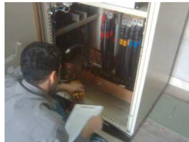
اندازه‌گیری شدت مصرف برق از روی پست‌های برق
