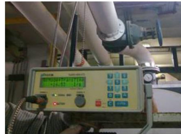
اندازه‌گیری دبی جریان آب گرم مصرفی ساختمانها
